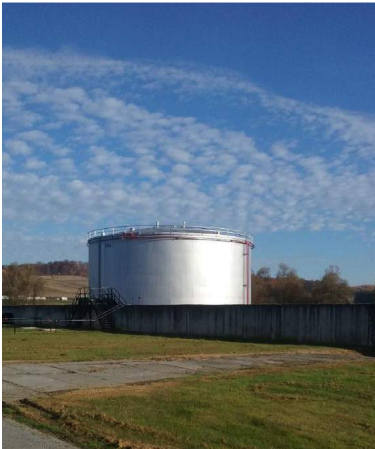
Slika 28. Spremnici nafte (5 000 m 3 )
